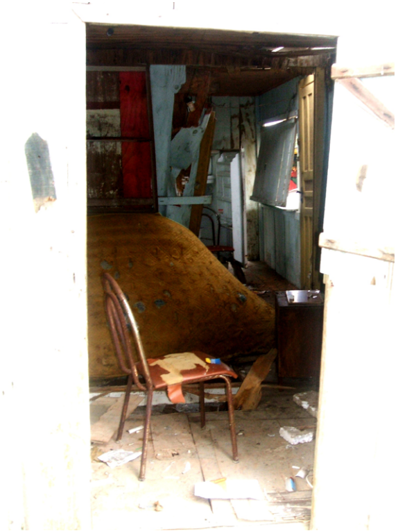
Figura 6 - Interior de residência abandonada de afrodescendentes em pontal do Paraná
